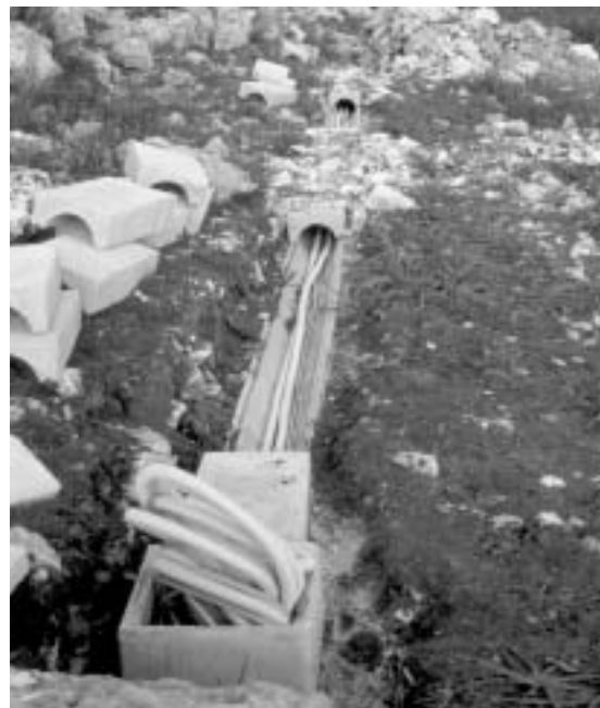
Fig. 9 - Visione dal basso della posa dei cavi sulla collina di Lamalunga nel tratto che va dall'ingresso della grotta alla base della collina.
